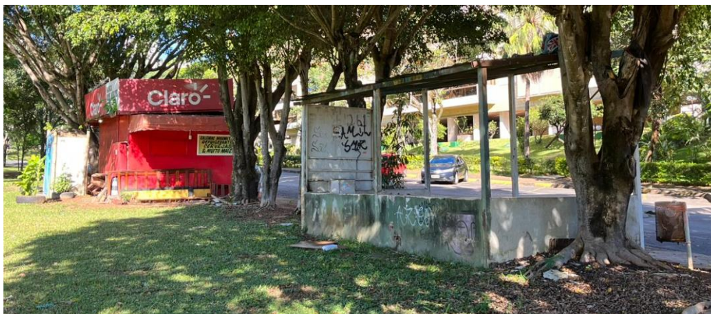
Foto 6 - Mobiliário urbano abandonado e deteriorado na SQN 205
